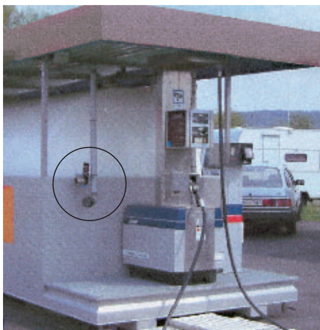
Anläggning med lättåtkomlig lossningskoppling
