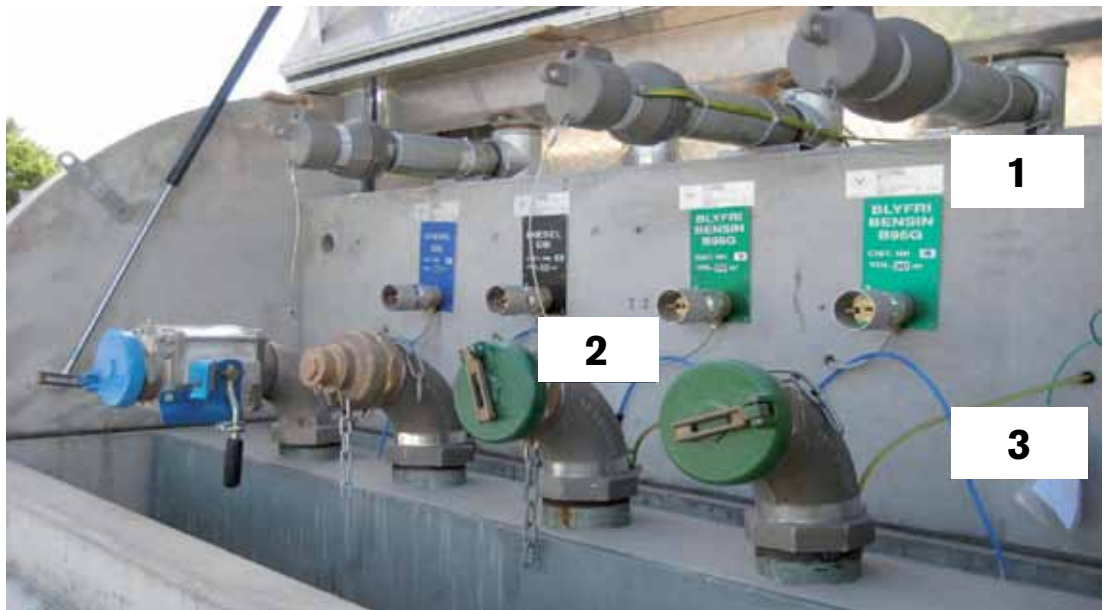
BILD 3. FÖRBINDNING AV PÅFYLLNINGSRÖR OCH GASRETUR SAMTLIGA POTENTIALUTJÄMNINGSLEDARE HAR GUL/GRÖN FÄRG
